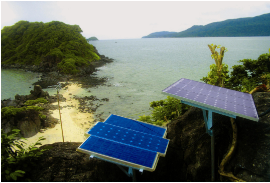
Hình 1. Trạm điện mặt trời thuộc dự án “Nâng cấp và phát triển hệ thống điện mặt trời Côn Đảo”
